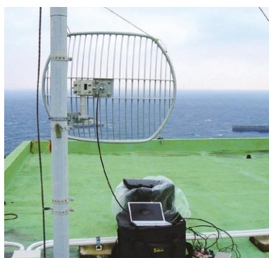
三島村竹島に設置した無線LAN/パラボラアンテナ
